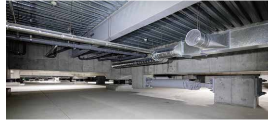
(写真1) 免震ピット階 免震層
